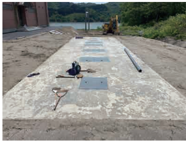
一次処理槽(手前)、消毒・貯留槽(奥)
