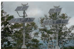
太陽光発電システム
