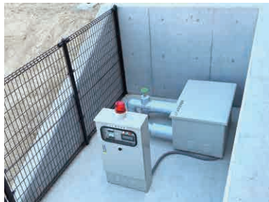
制御盤、ポンプなど設備機器
