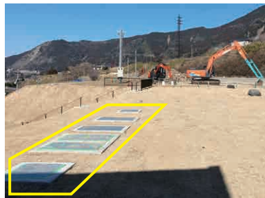
一次処理槽(手前)、消毒・貯留槽(奥)
