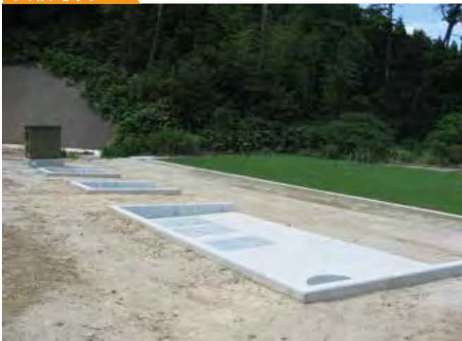
一次処理槽、消毒・貯留槽
