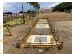
一次処理槽(管理棟側)
