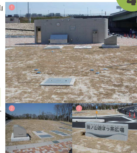
① トイレ建屋、土壌浸潤槽 ② 一次処理槽、消毒・貯留槽、他設備等 ③ 施設名
